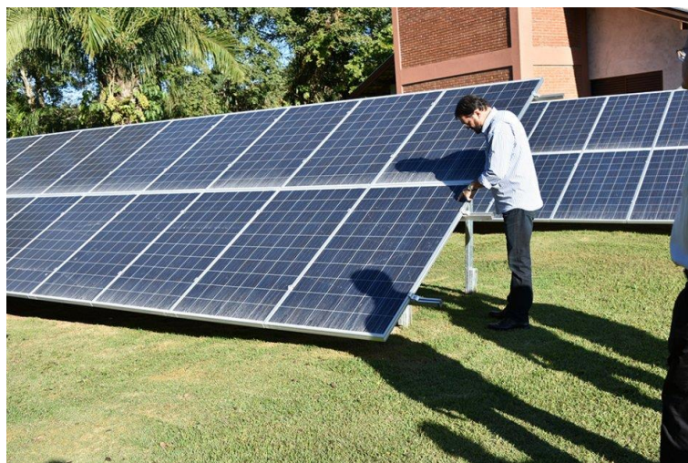
Figura 25 - Painéis Fotovoltaicos do EcoSesi
