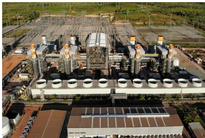
Figura 4- Usina Termoeletrica (UTE)
