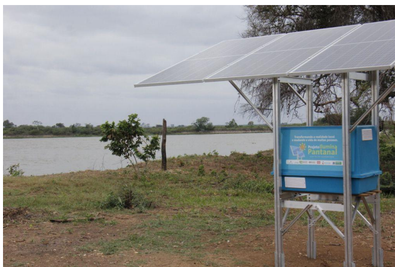
Figura 14 - Instalação de geração de energia fotovoltaica no Pantanal
