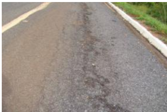
Foto 16 - Detalhes da pista com defeito na BR-267 (Jardim - Porto Murtinho), em 03 de junho de 2010.
